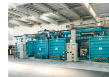
青果センターに導入された真空予冷設備
